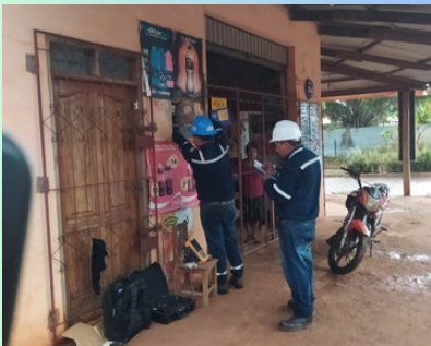
Verificación de medidores
