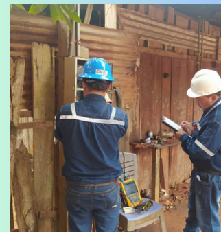
Verificación de medidores
